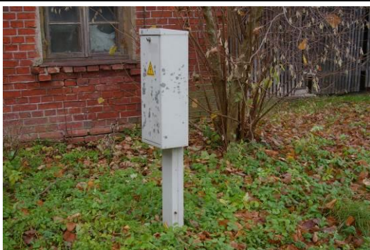
Zemes gabals ar kadastra apzīmējumu 6448 005 0303, elektroenerģija pievads
